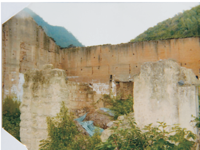
1944 年 8 月丽水县上黄村周柴坞家民房被日军烧毁留下的断壁残垣。 (樊寿康摄于 2007 年 9 月 15 日,原照片存于丽水市莲都区史志办公室“抗战损失”课题调研资料 11-11-01-39 卷)
